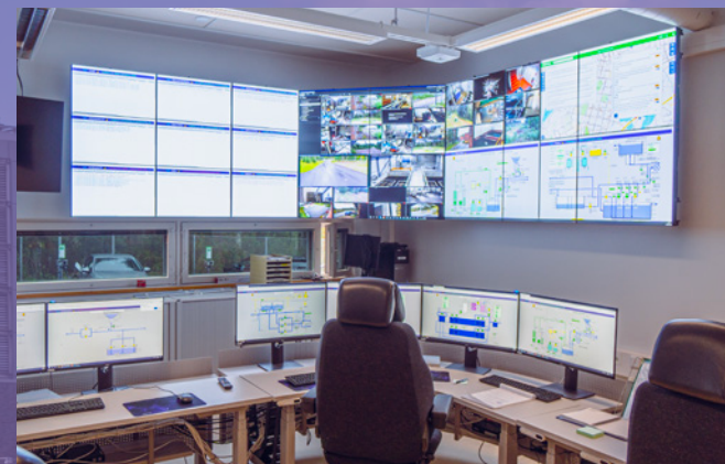
Mikkelin vesilaitoksen päävalvomo.
