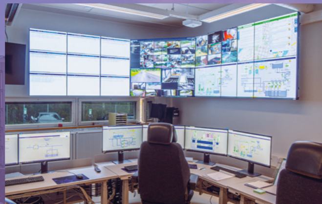
Mikkelin vesilaitoksen päävalvomo.
